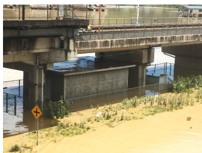
水没した吉備真備駅電気機器室
